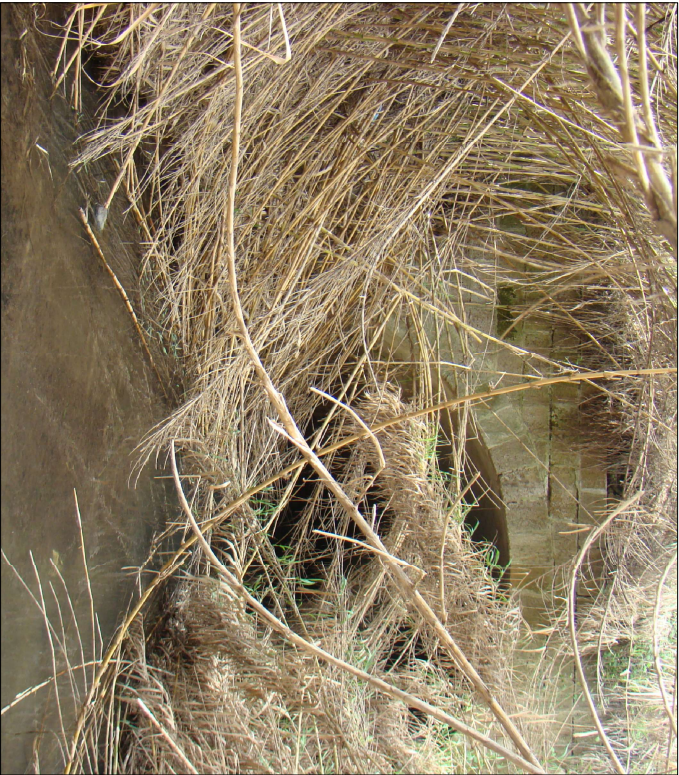
Foto 25 Fosso di Vallerano. In foto è visibile il tombino sotto via C. Colombo (lato Pontina).
